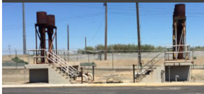
Quemadores de gas residuales
